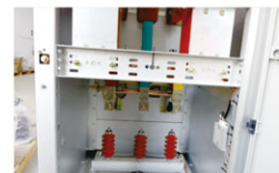
C 电缆室 Cable chamber
